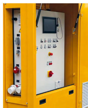
Elektroschrank mit Steuerung Electrical cabinet with control system
