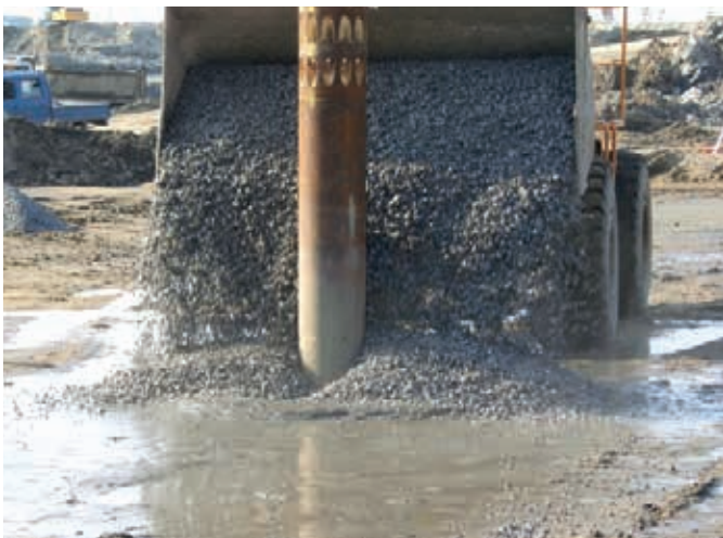
Befüllung an der Oberfläche „Top Feed“
